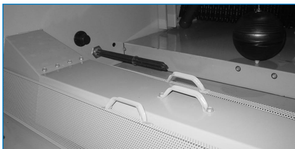
Bassin d'eau froide et tamis
