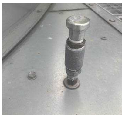
Évent sur plate-forme de ventilateur
