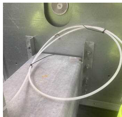
Ligne de raccordement
